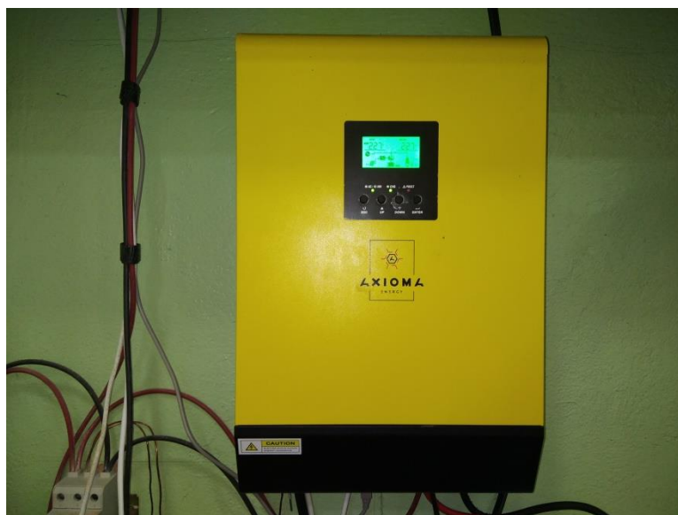
Рис. 2. Гібридний інвертор Ахіома, до якого підключені блок фотоелектричних панелей, електромережа і акумуляторні батареї.
