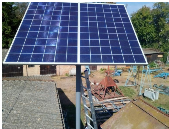
Рис. 1. Фотоелектричні панелі на двохосьовому трекері
